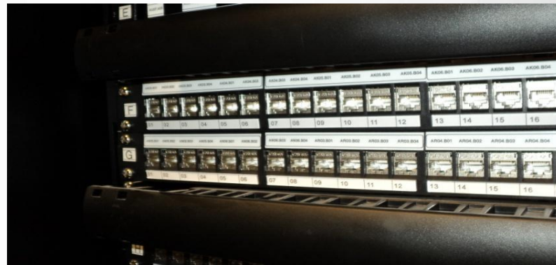
IDENTIFICAÇÃO NAS PORTAS DO PATCH PANEL
