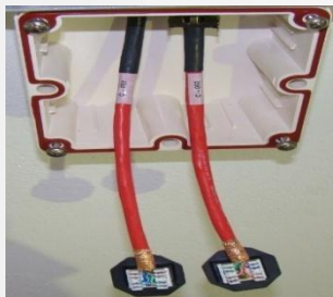
PERMANENTE LINK IDENTIFICADOS NO CABO (ÁREA DE TRABALHO)
